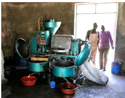
Ölmühle/Presse mit Solarenergie
